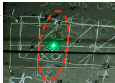
【図2】新幹線トンネル内のコンクリート欠陥箇所(表面クラック部分が小さく落下する危険性はない)
