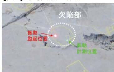
【図2】検査箇所(欠陥部)の写真
